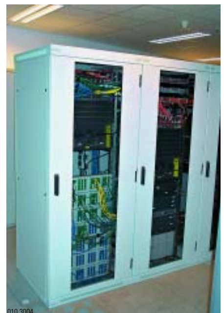
Kompakt und übersichtlich: Ein Verteilschrank mit Komponenten von R&M
