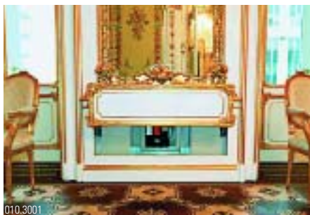
Hinter historischer Wandvertäfelung versteckte Anschlussmodule
