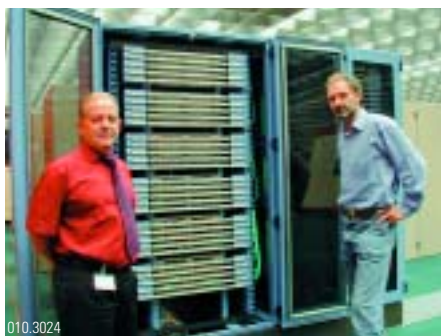
Das Rechenzentrum von Roche in Basel erreicht mit FOM-Systemen von R&M eine neue Dimension des Kabelmanagements. Für Roland Nyfeler (rechts), Leiter EDV-Installation bei Roche, realisierte Christian Reck von R&M (links) im Eiltempo eine individuelle Lösung. Foto: B. Damm
