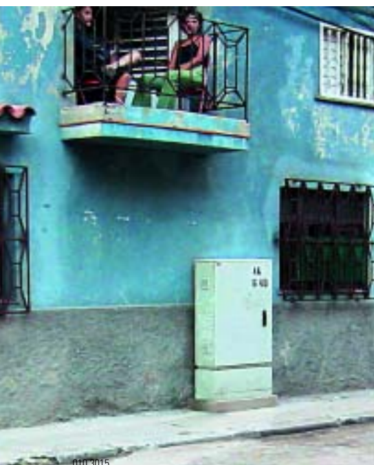
010.3015 Ein Cross Connection Cabinet in der Altstadt von Havanna
